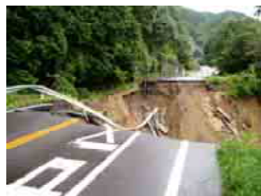
豪雨による現道の災害状況
