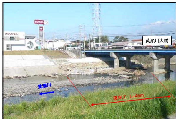
災害復旧箇所
