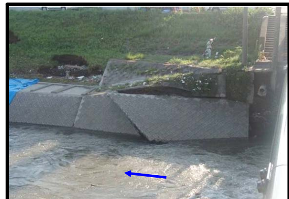
護岸被災状況（正面より）
