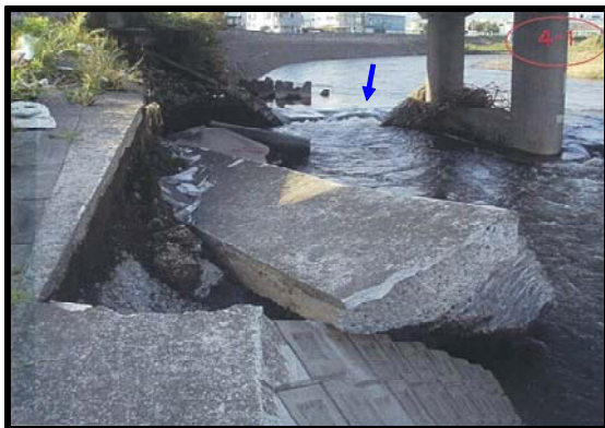
護岸被災状況（下流側より）
