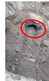
横断水路継ぎ目部に隙間が発生
