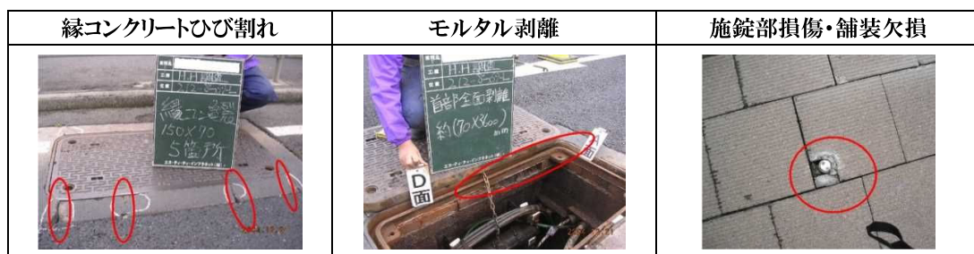
図 3-2 鉄蓋(上蓋・受枠)の損傷例
