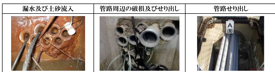
図 3-4 特殊部(管路取付部)の損傷例
