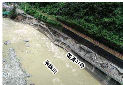
令和2年7月豪雨 国道41号
