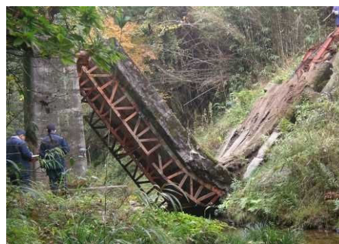
写真1 老朽化が原因で落橋した国内事例
