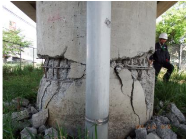
写真-7 段落し部の損傷
