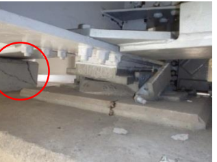
写真-6 支承の破損の状況
