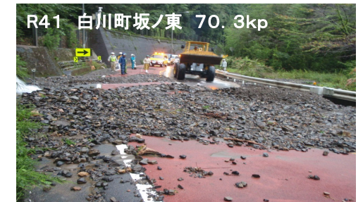
H23.9法面崩落状況(白川町坂ノ東)
