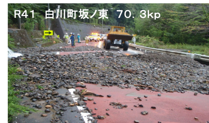
H23.9法面崩落状況(白川町坂ノ東)
