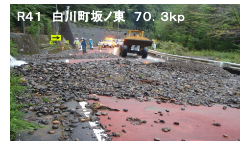
H23.9法面崩落状況(白川町坂ノ東)
