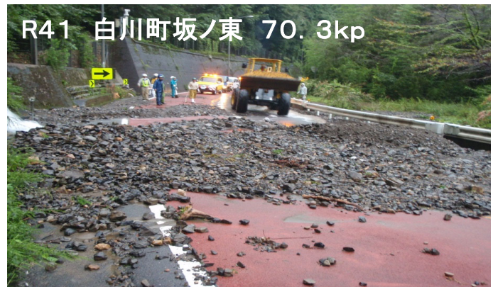
H23.9法面崩落状況(白川町坂ノ東)
