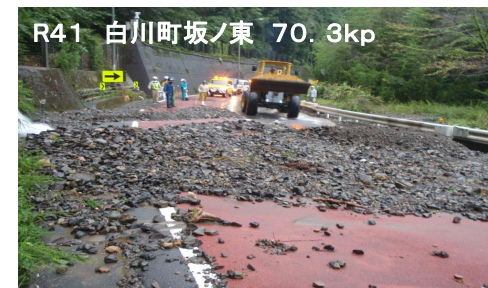
H23.9法面崩落状況(白川町坂ノ東)
