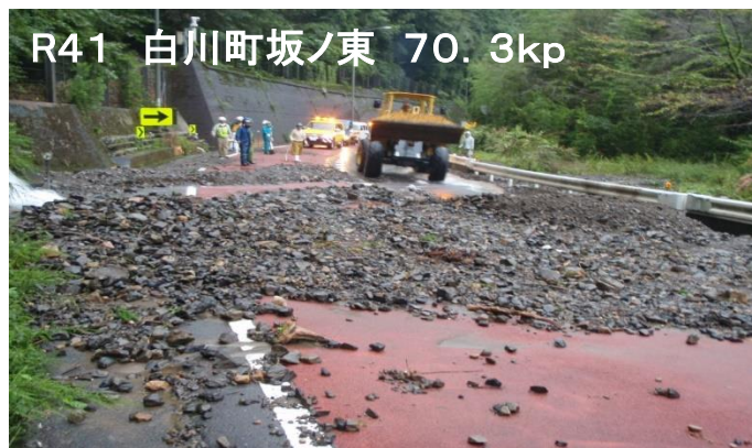
H23.9法面崩落状況(白川町坂ノ東)
