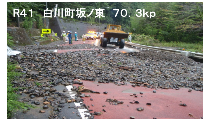
H23.9法面崩落状況(白川町坂ノ東)
