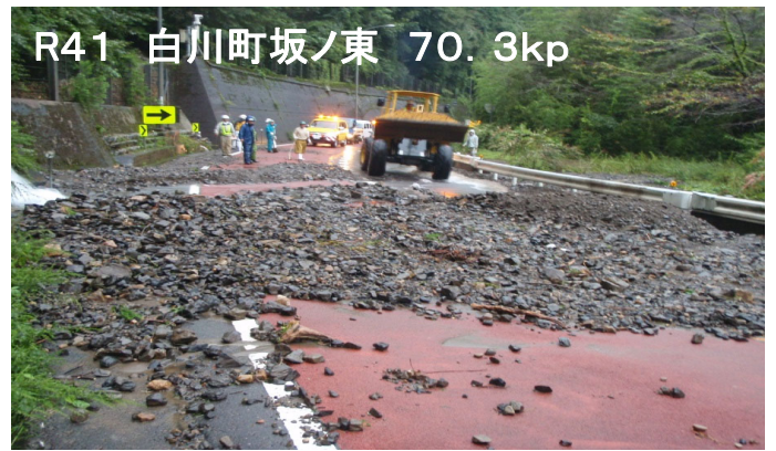
H23.9法面崩落状況(白川町坂ノ東)
