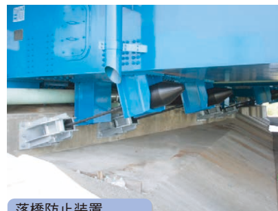
落橋防止装置
