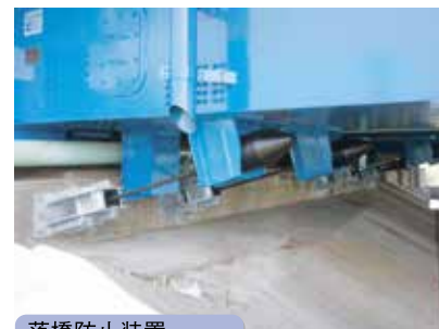
落橋防止装置
