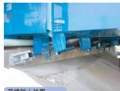
落橋防止装置
