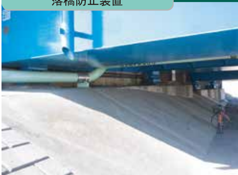
落橋防止装置
