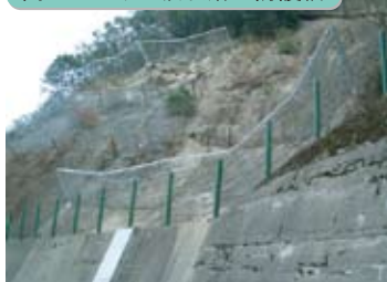
高エネルギー吸収落石防護柵
