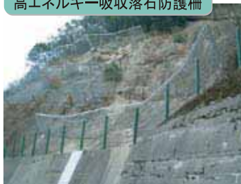
高エネルギー吸収落石防護柵
