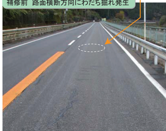
補修前 路面横断方向にわだち掘れ発生
