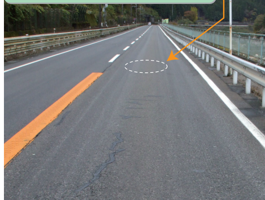
補修前 路面横断方向にわだち掘れ発生
