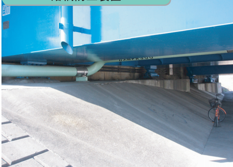
落橋防止装置
