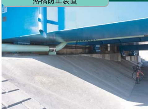
落橋防止装置
