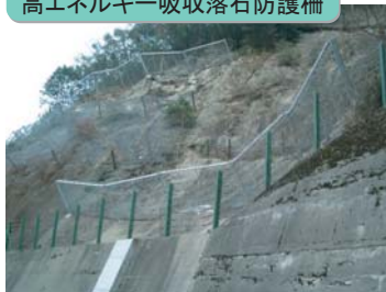
高エネルギー吸収落石防護柵
