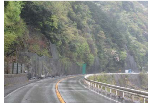
急斜面と飛騨川にはさまれた空間を通るため、斜面からの落石、土砂崩れのリスクを有しています。
