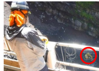
リモコン操作によるBH操作
