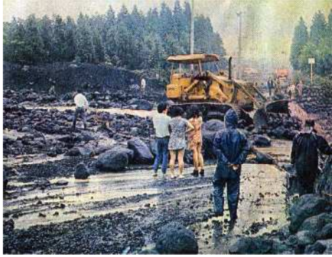
富士宮市上井出の河底橋 (昭和47年7月12日土石流による被災状況)
