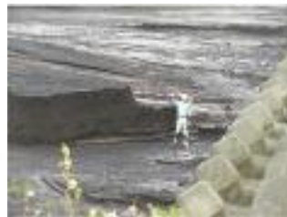
現地調査状況 (平成23年9月21日台風第15号)
