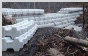
ブロックえん堤工 (平成26年 御嶽山)
