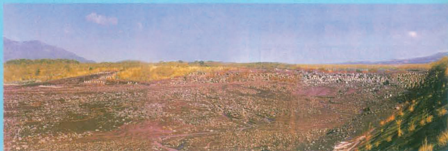
▲土砂流発生後の大沢沈砂地工……除石前の姿にもどってしまいました。現在、再び除石工を行っています。
