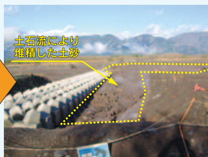
土石流発生後 第7上流床固工
