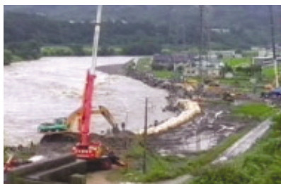
天竜川右岸の堤防決壊現場
