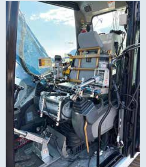
ロボQSの設置状況
