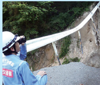
被災状況調査（レーザー距離計）
