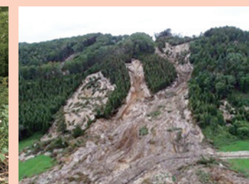
斜面崩壊状況 (ドローンによる空撮写真)
