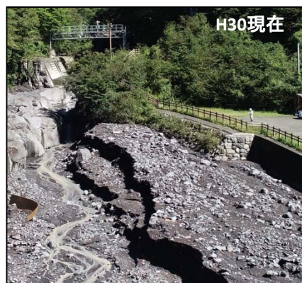
①岩樋付近 護岸天端付近まで土砂が堆積
