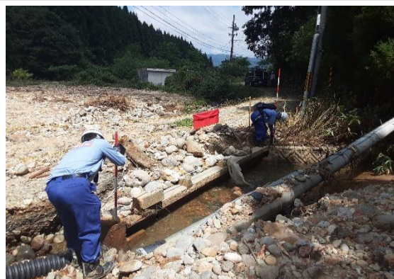
山形県庄内町三ヶ沢 被災状況の調査
