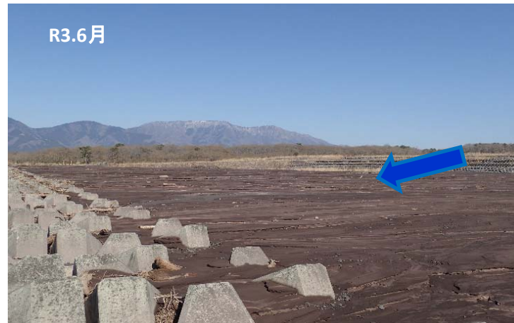
①扇状地内の堆積土砂の撤去 第6上流床固 堆砂状況
