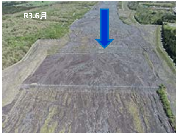
①扇状地内の堆積土砂の撤去 第6上流床固 堆砂状況
