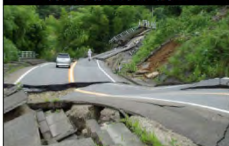
地震による道路陥没箇所の原因調査
