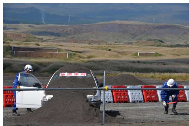
放置車両の安全確認
