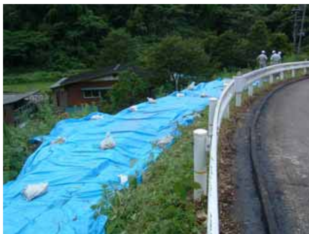
人家裏の斜面にクラック(長岡市大積千本町)危険度A
