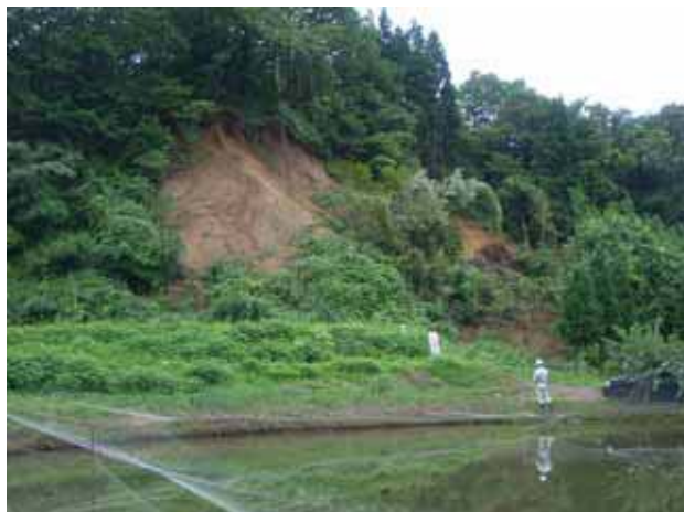
斜面崩壊(長岡市大積熊上町)危険度A
