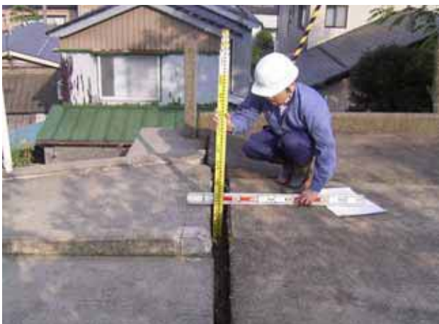
擁壁にクラック(柏崎市中浜1丁目)危険度A
