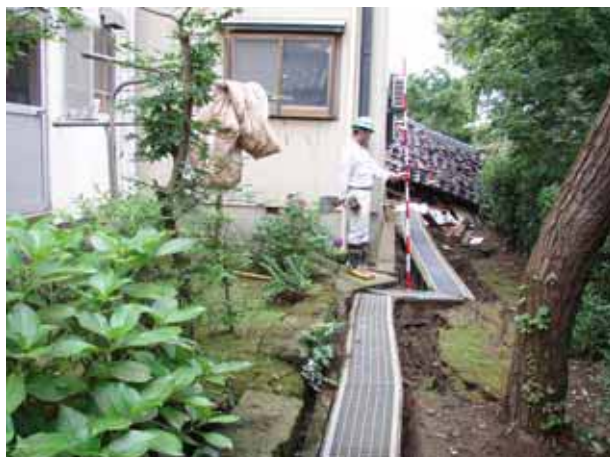
斜面頭部に段差(柏崎市西港町)危険度A
