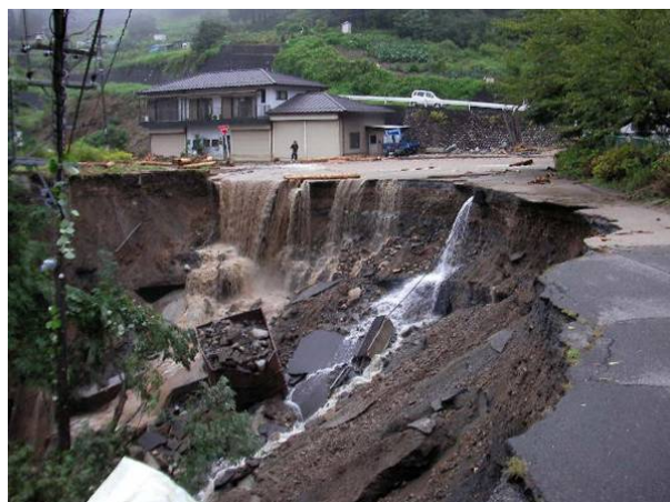
平成20年9月 西濃豪雨 国道303号寸断 (2008年) (揖斐川町東津汲)
