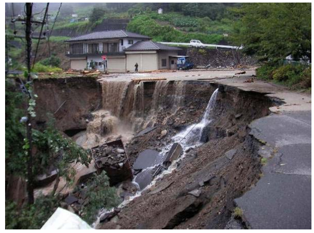
平成20年9月 西濃豪雨 国道303号寸断
