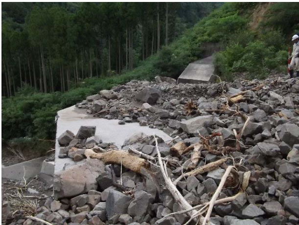
平成23年 土石流（越波）
