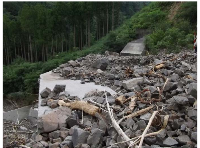
越波谷第3砂防堰堤土石流補足(平成23年8月発生)
