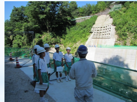
現場で働く若手技術者の声を聞く （地谷第2砂防堰堤工事）
