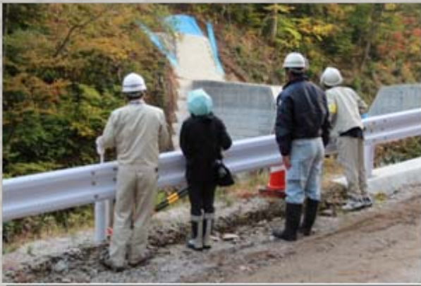
建設が最終段階となった瀬戸谷第1砂防堰堤 (鋼製透過型砂防堰堤)
