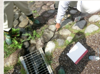
溪流保全のため整備した 石段の亀裂も確認
