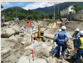
南木曽町土砂災害の被害調査
