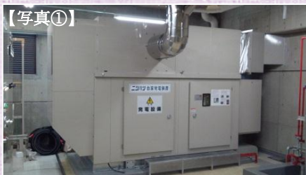
更新した発電機 (出力:125kva)
