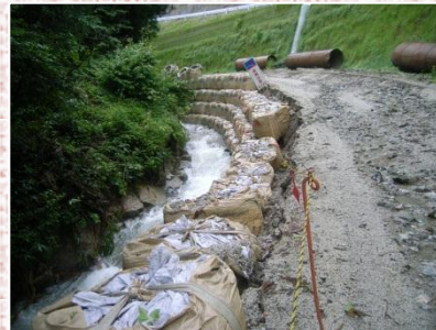
大型土嚢の洗掘 (瀬戸谷)
