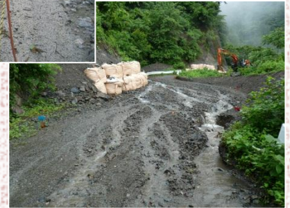
林道の土砂流出 (東前の谷)
