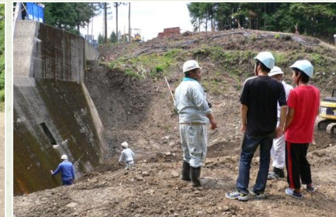
小砂谷では、改築が進む砂防堰堤を見学 (施工：田中建設工業(株))
